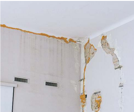
Vidna oštećenja na zidovima
