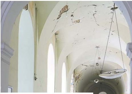
Oštećenja su i na svodovima
