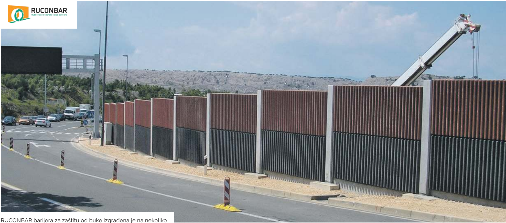
RUCONBAR barijera za zaštitu od buke izgrađena je na nekoliko lokacija na prometnoj infrastrukturi u Hrvatskoj
