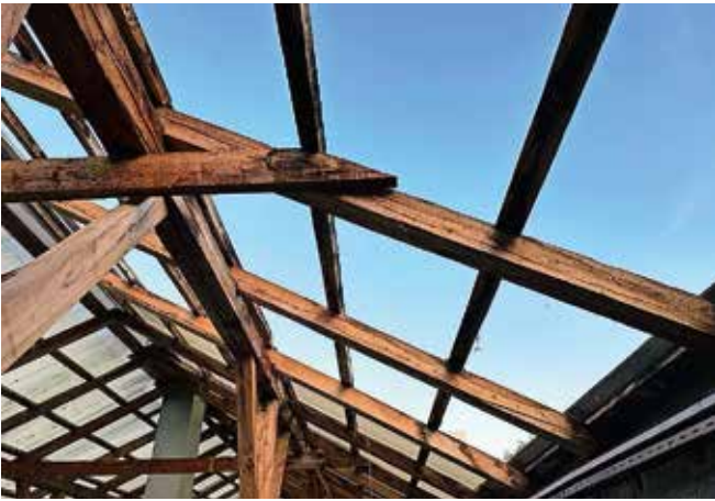
Oštećeno krovšte Veterinarskog fakulteta
